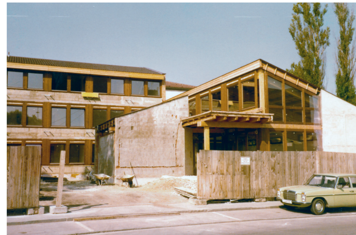
Im weiteren Baufortschritt nimmt auch der neue Eingangsbereich zwischen Saalbau (rechts) und Trauzimmer Gestalt an.
